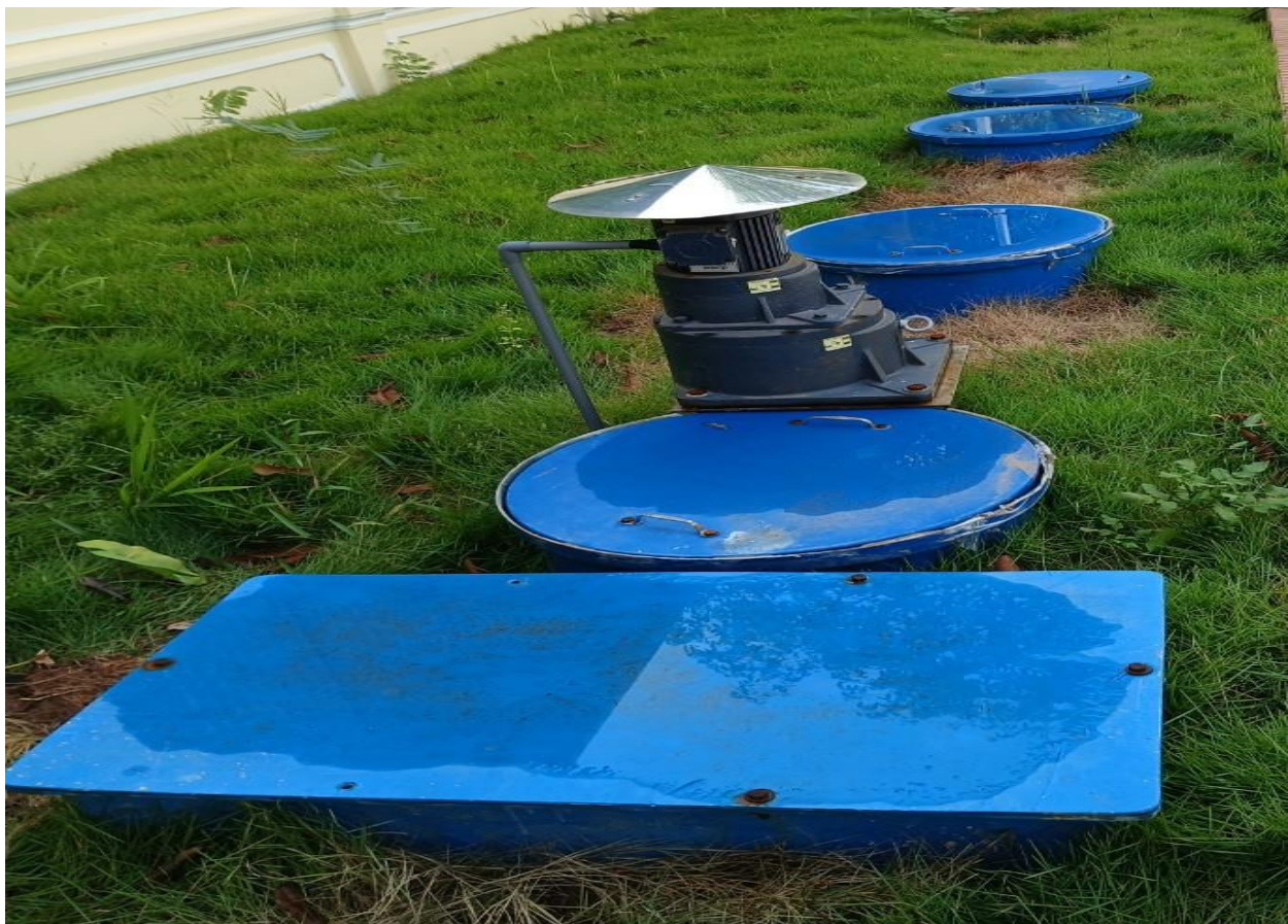
Hình 3.3. Hệ thống xử lý nước thải tập trung của Trung tâm Y tế
